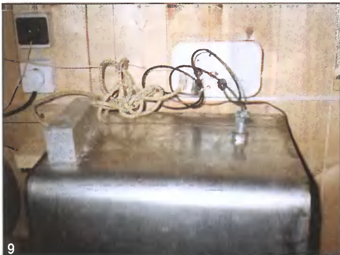
9 Температурный датчик, смонтированный на бойлере.
